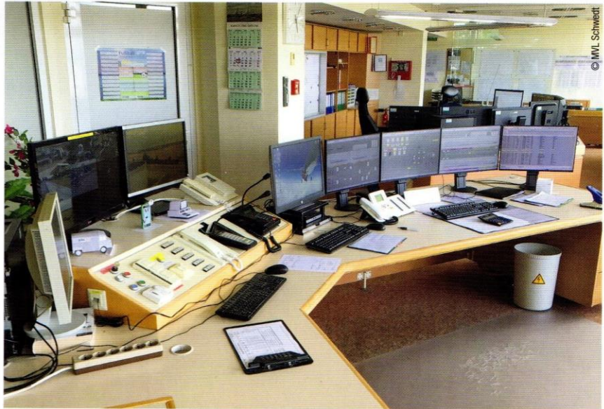
Abb. 2: Bis vor kurzem waren die Operatoren in dieser 20 Jahre alten Leitwarte untergebracht. Zuletzt gab es pro Arbeitsplatz acht Bildschirme, um die steigenden Aufgaben der Leitwarte zu bewältigen.
