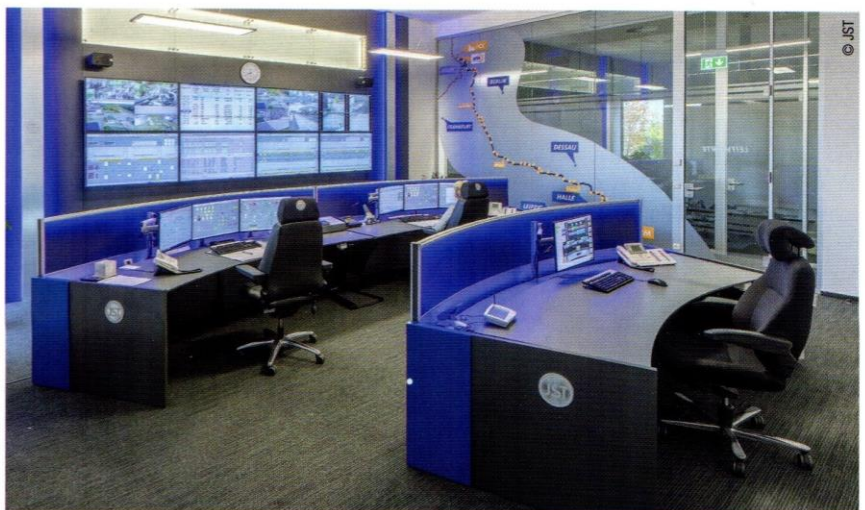
Abb. 3: Im Zuge der geplanten Modernisierung des gesamten Unternehmens entschieden sich die Verantwortlichen einen neuen, repräsentativen Kontrollraum einzurichten.
